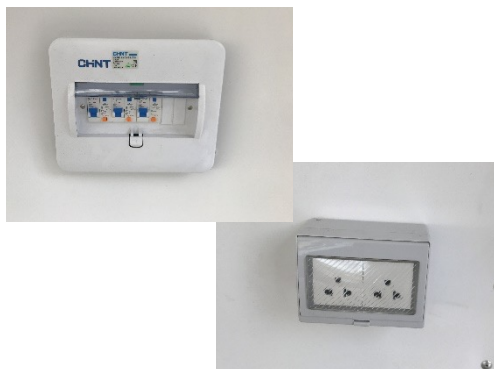
●車内コンセント、ブレーカー
