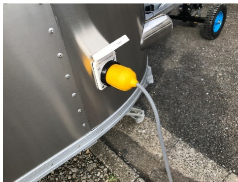
●外部電源引き込み口
