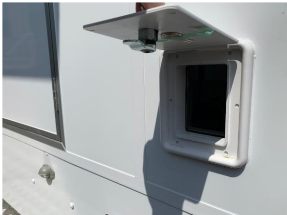
●ケーブル引き込み口
