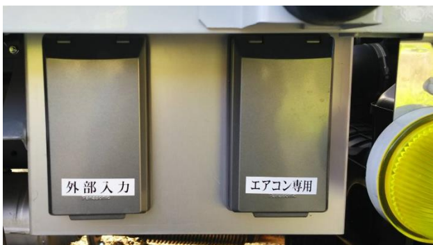
●外部電源引き込み口 (100V 1500w+エアコン用)
