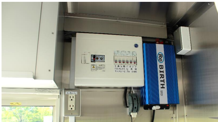
●外部電気引込みブレーカー (15A) 車内コンセント
