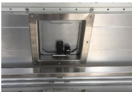
●ケーブル引き込み口×2
